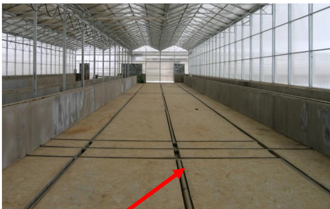
لوله های سیستم هوادهی از کف سالن
